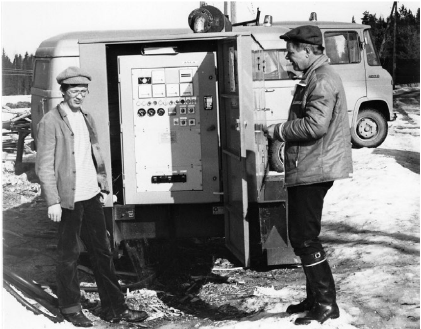
Markku Kariluoma (vas.) ja Erkki Aho tutkivat 200 kVA:n varavoimakonetta Sänkiahossa. Kuva: Alajärven Sähkö Oy:n arkisto / Valokuvat
