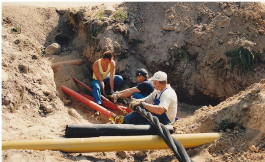
Maakaapelin vetoa Alajärven keskustassa, vasemmalta puhelinyhtiön Arto Kytölä sekä Alajärven Sähkö Oy:n Mikko Mannila ja Mauno Haapa-aho. Kuva: Alajärven Sähkö Oy:n arkisto / Valokuvat
